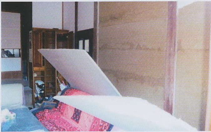
●家の壁も崩れた
