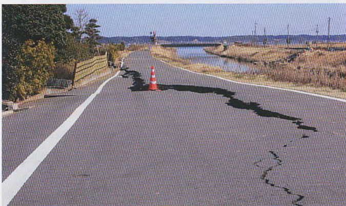
●行方市・堤防の亀裂
