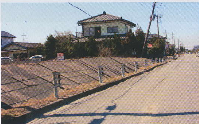
●歩道も歩けないほどの傾き
