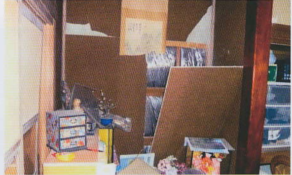
● 床の間の壁も倒壊
